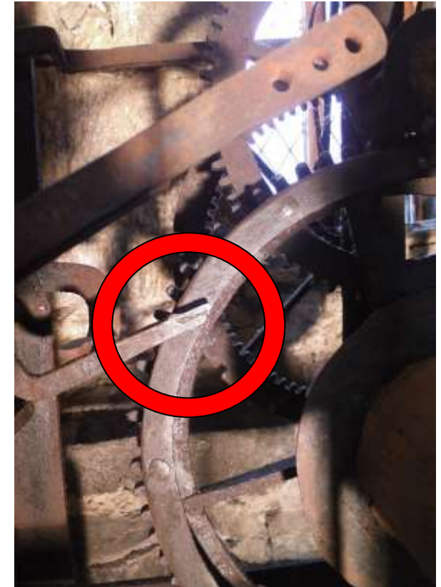
Auslösehebel für den Glockenzug falsch positioniert, d.h. Schlagwerk defekt 30.11.2017
