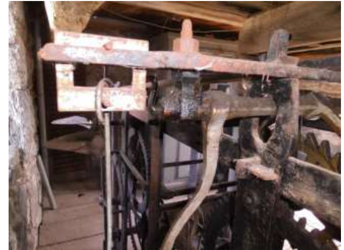
Detail aus der Pendelaufhängung mit starkem Rostansatz 05.05.2014
