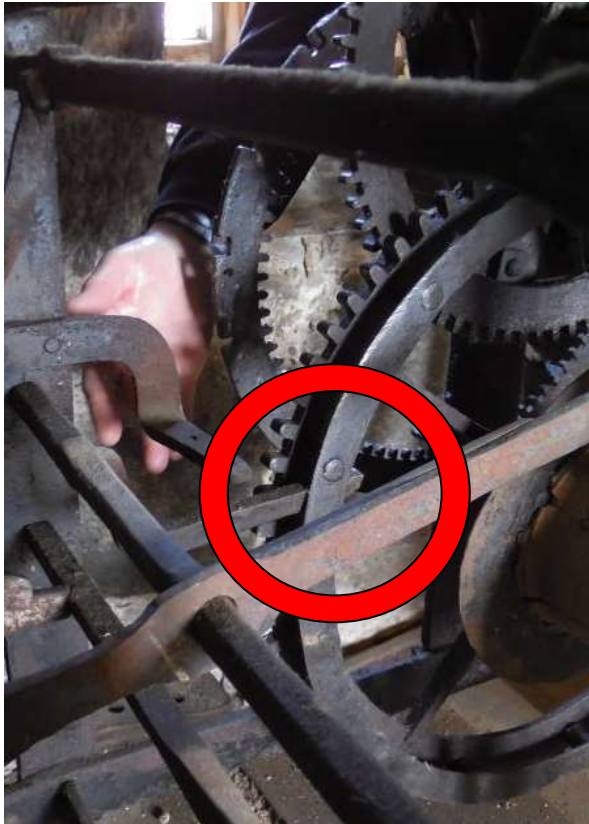
Auslösehebel für den Glockenzug richtig positioniert, d.h. Schlagwerk i.O. 26.04.2014
